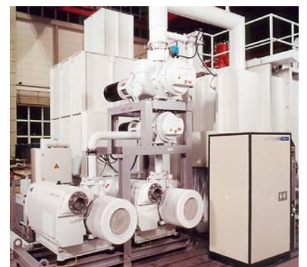
Fein- und Hochvakuumpumpstand
